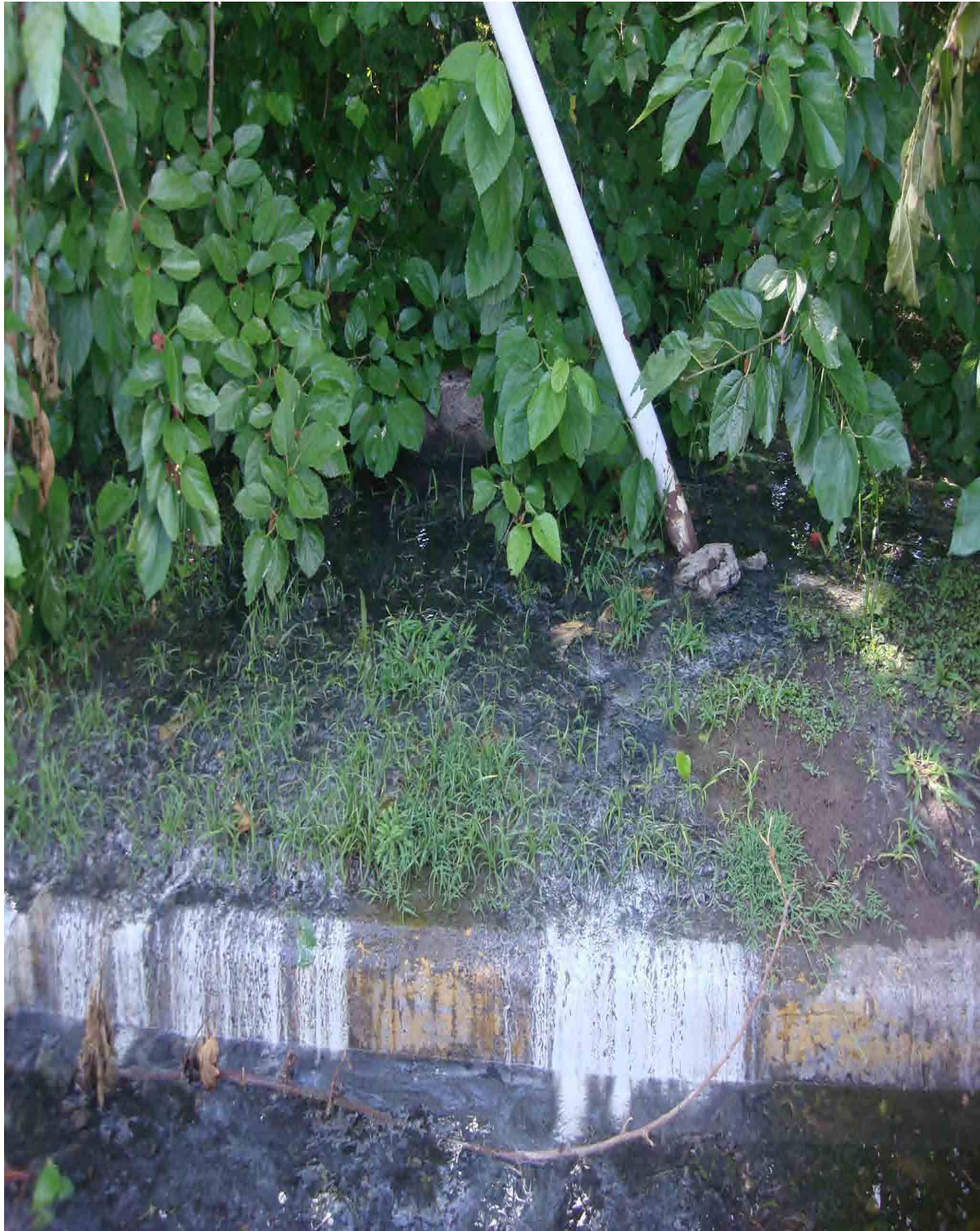
Foto N ° 22: Aguas sobre la pista, olores de cámara o poso carteles inclinados.
