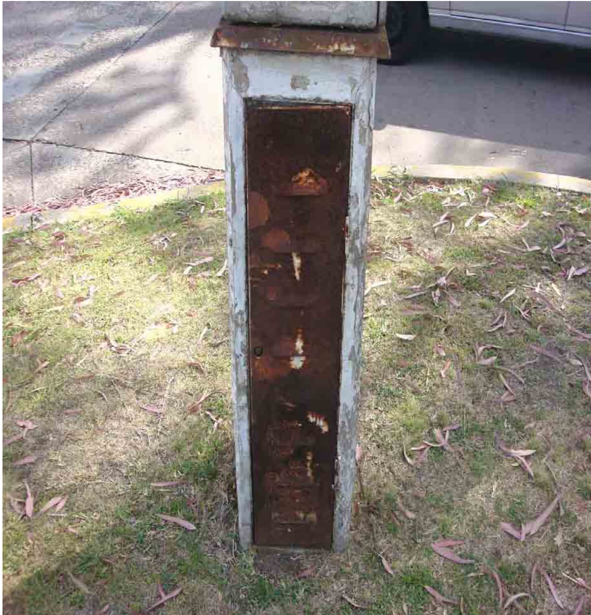
Foto N ° 26: Caja central de electricidad en mal estado (oxido).
