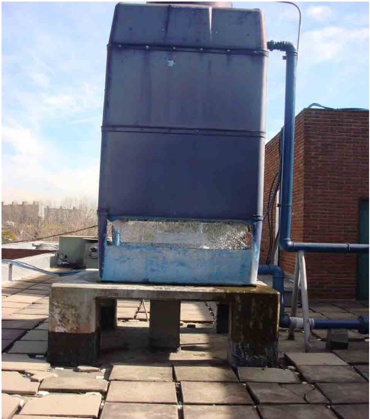
Foto N ° 9: Vista de la torre de enfriamiento funcionando, se puede observar la lluvia de agua que cae en la batea inferior pero parte la rebalsa y sale hacia el piso flotante que se encuentra roto en parte y en parte sin losetas, quedando el líquido estancado en varios sectores.
