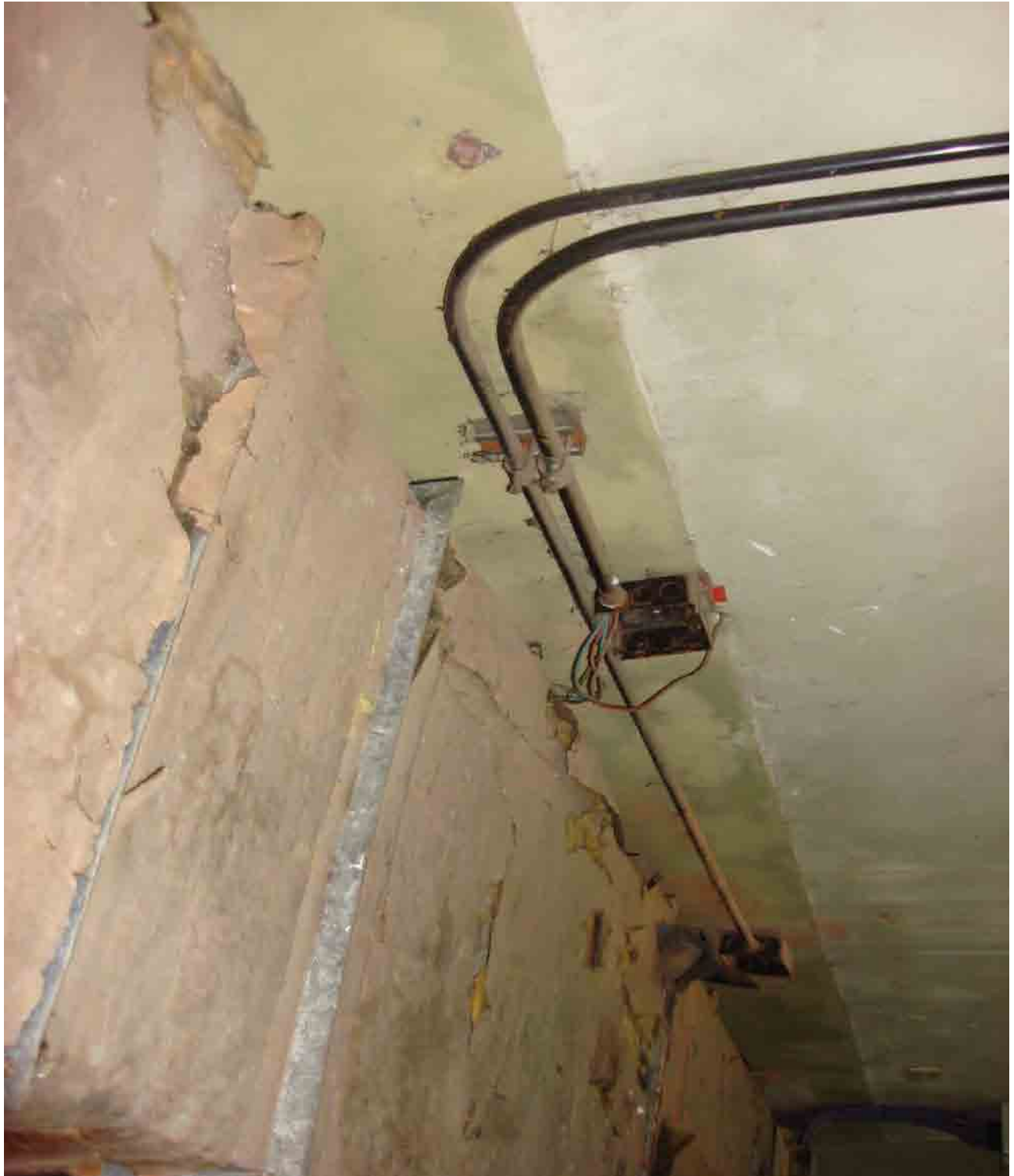
Foto N ° 12: Vista del cielorraso del recinto donde están los equipos de AA en este lugar se observan cables de electricidad expuestos que salen de cajas de derivación de electricidad sin tapas y manchas de humedad en el techo y en las paredes.
