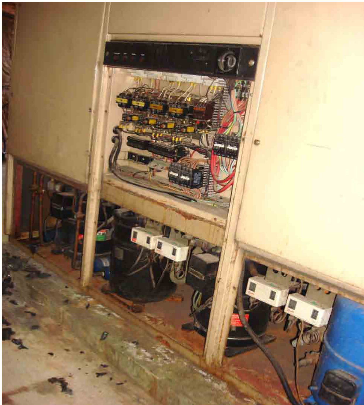
Foto N ° 11: Vista de otros equipos de AA ubicados en un recinto sobre la azotea del edificio donde podemos observar la instalación eléctrica expuesta sin tapas y contratapa de protección y con humedad en el piso.
