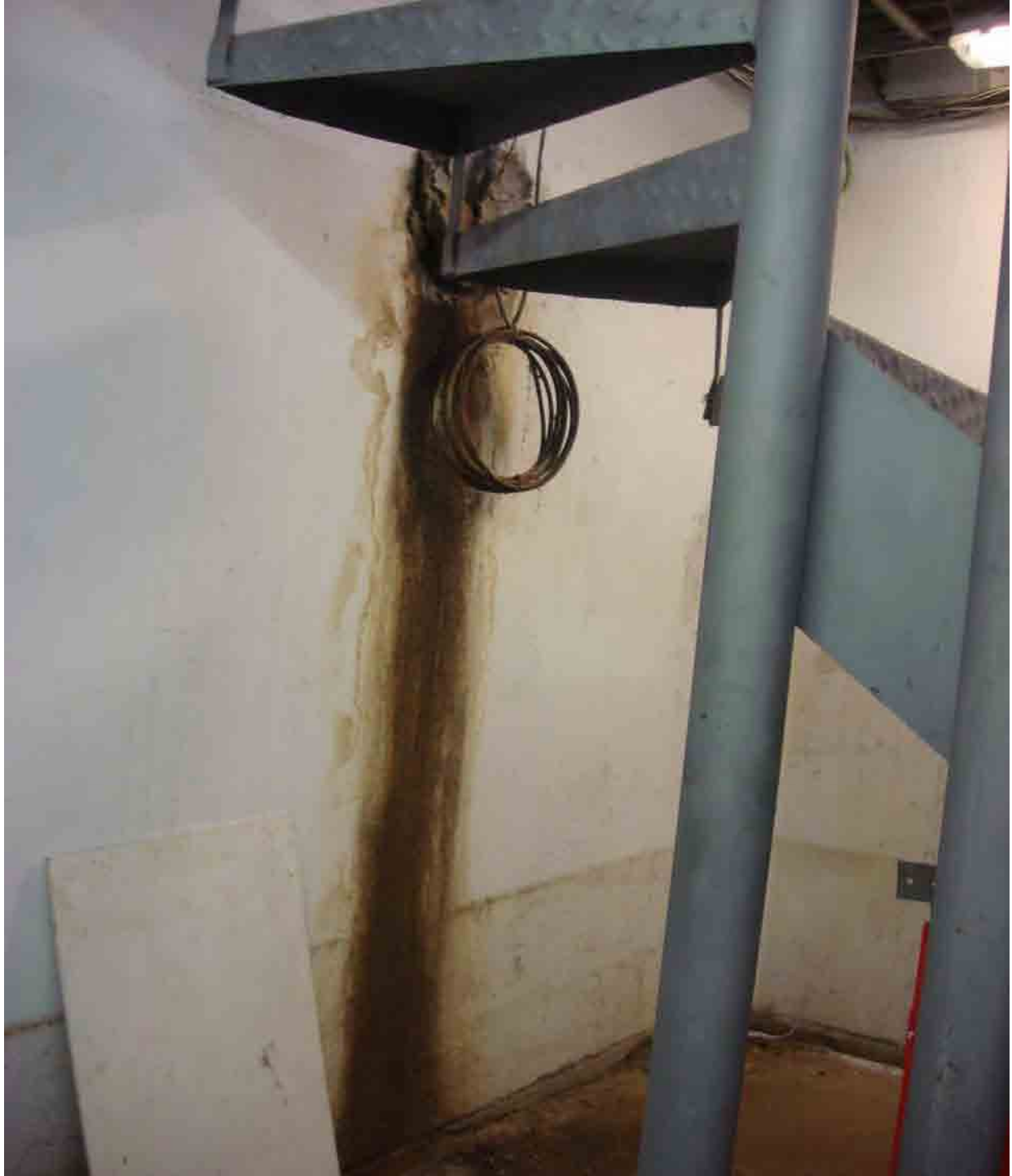
Foto N ° 17: Vista de otro sector del sótano donde se puede observar humedad en las paredes y detrás de la escalera en la parte superior de la pared varios cables de electricidad expuestos.
