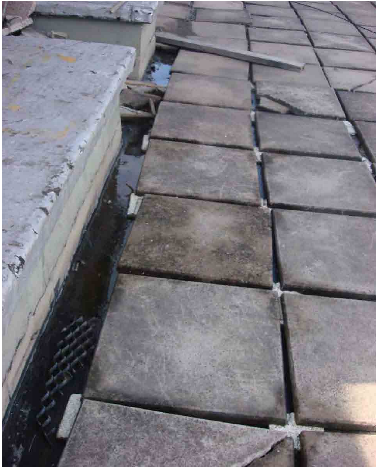
Foto N ° 10: Vista del solado de losetas de la azotea roto y con agua estancada debajo.
