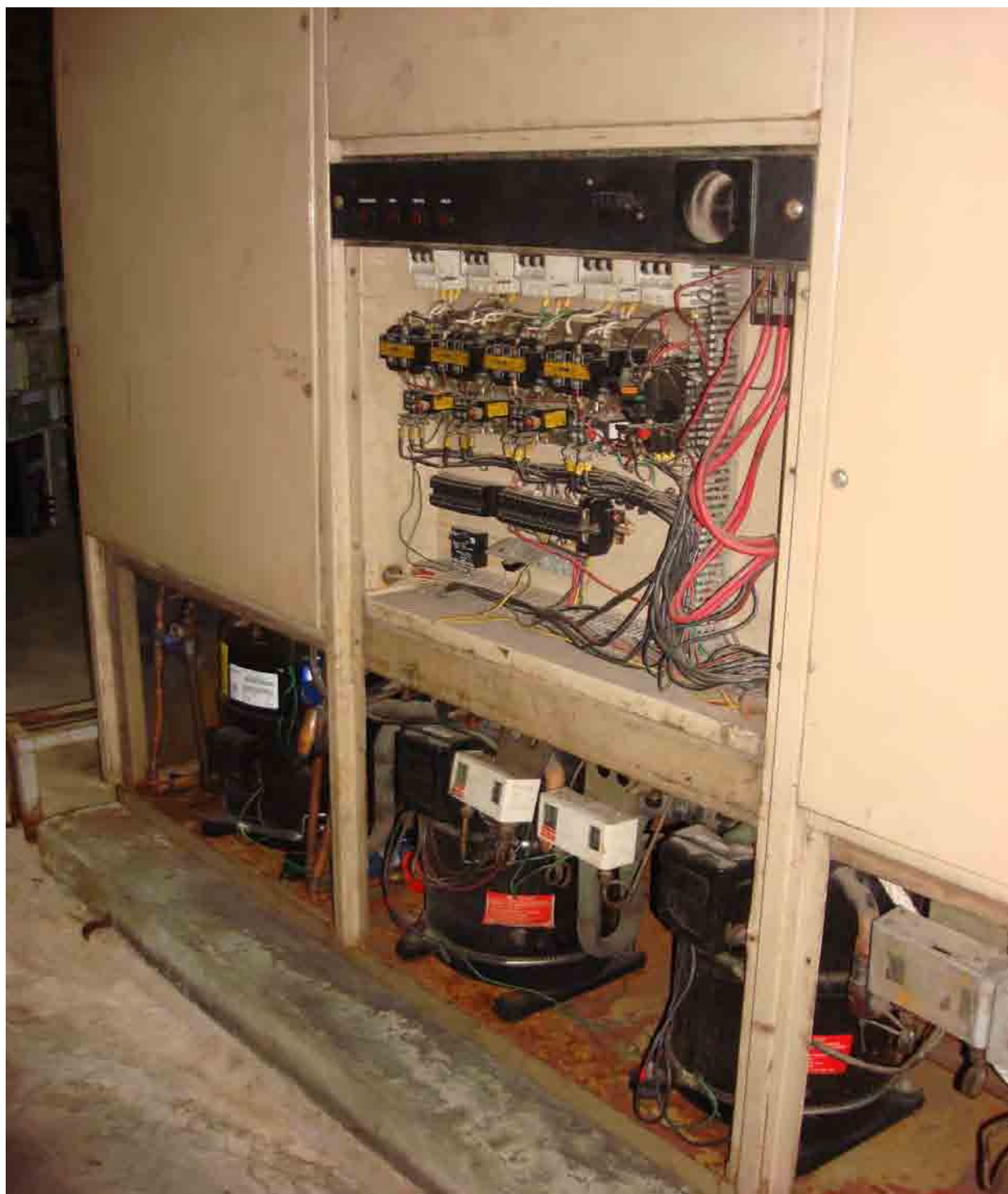
Foto N ° 6: Vista de los equipos de AA dentro de un recinto sobre la azotea del edificio, en el mismo podemos observar la instalación con los cables de electricidad expuestos y sin tapas y contratapas de protección.
