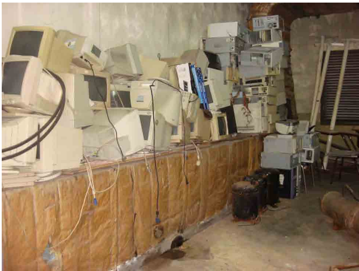
Foto N ° 7: Vista del lugar donde están los equipos de AA usado en parte como depósito de elementos de rezago. Es de notar la humedad que tienen todas las paredes.
