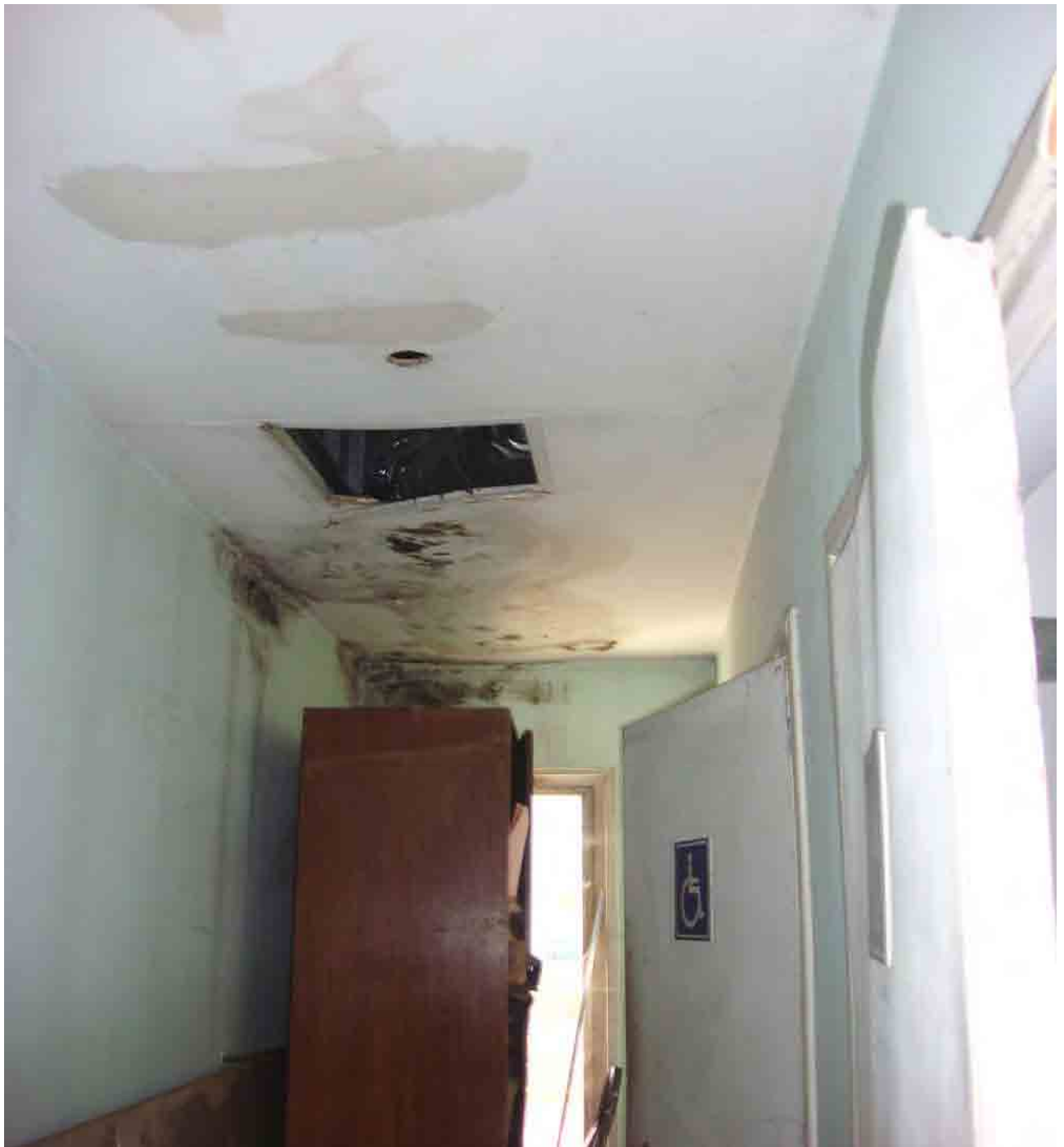
Foto N ° 13: Vista de un pasillo (con un mueble en el medio que dificulta el paso) donde se encuentran los baños de discapacitados, vemos en el cielorraso y las paredes manchas de humedad producto de filtraciones de agua, sin los artefactos de iluminación y con los cables de electricidad expuestos a la vista.
