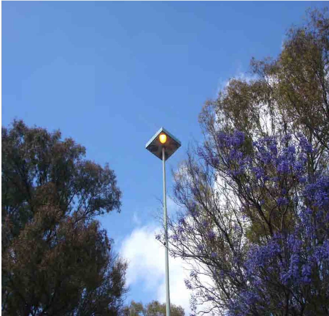
Foto N ° 24: Falta de mantenimiento en luminaria. Es escasa, prendida de día, una sola de cuatro.
