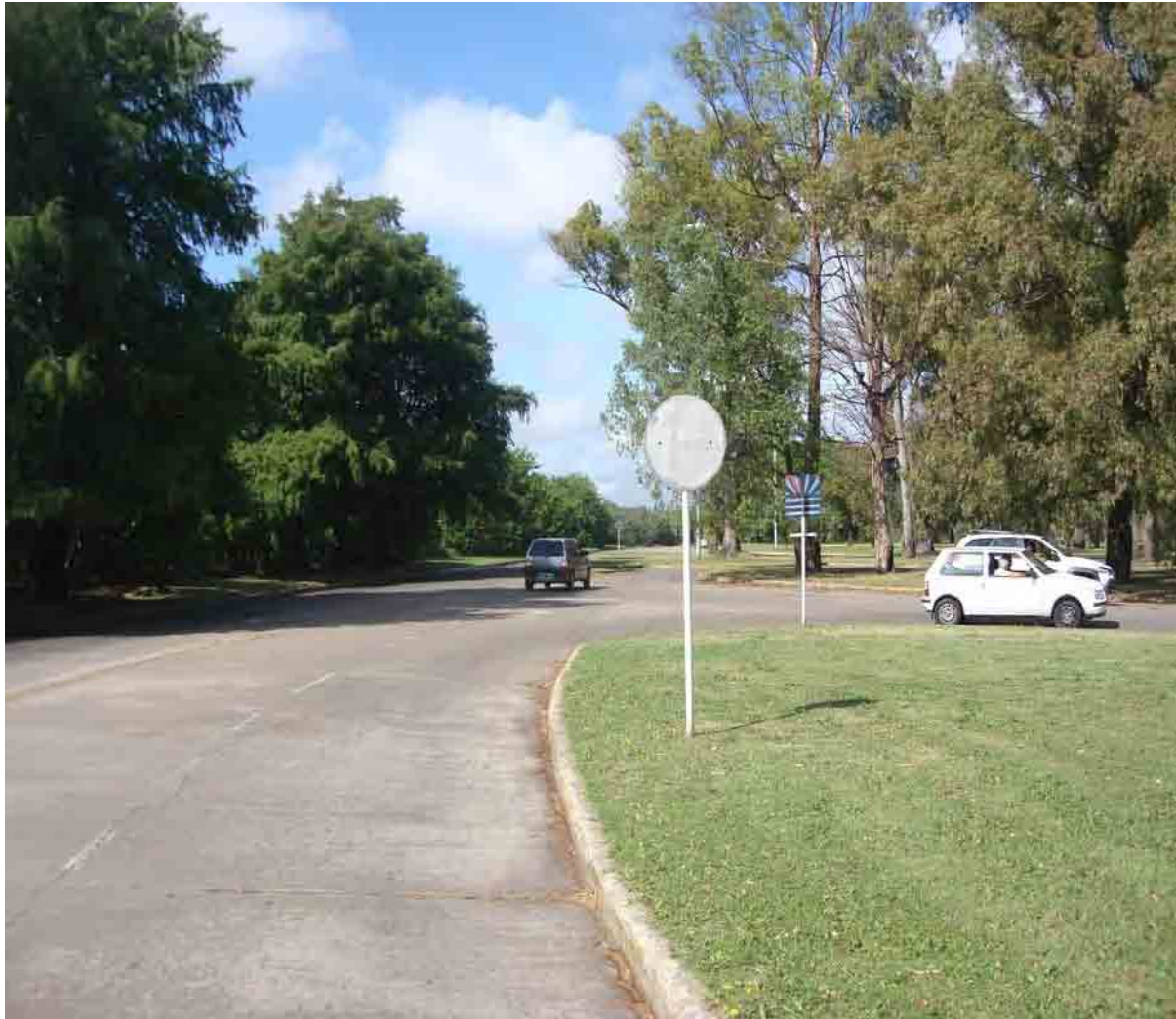
Foto N ° 25: Cartel y cordón despintado por completo.
