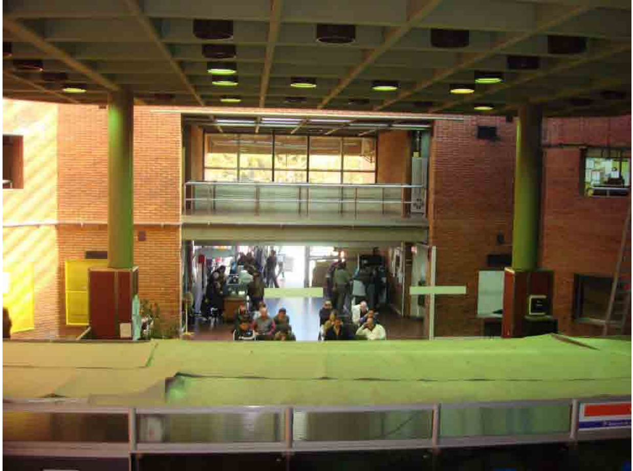
Foto N ° 2: Vista del acceso al Organismo desde en el interior del mismo, es de notar que el recubrimiento del techo de las oficinas instaladas en el hall de entrada son de cartulinas (muy combustibles y desprolijo).
