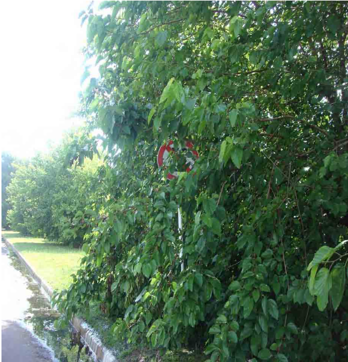
Foto N ° 21: Vegetación tapando señales, aguas de poso tapado.
