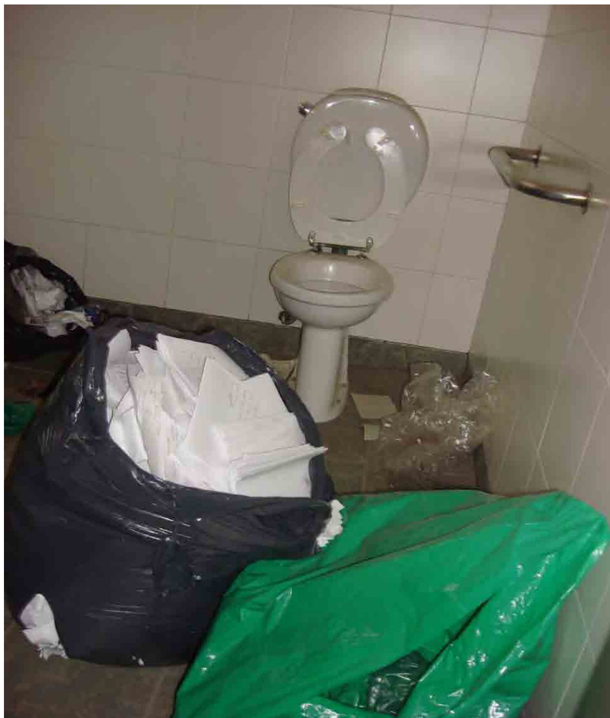
Foto N ° 14: Vista del interior de un baño de discapacitados (a este nivel no pueden acceder porque no funcionan los ascensores) usado como depósito de basura.
