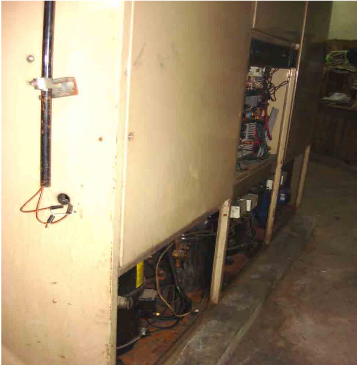
Foto N ° 8: Vista de los equipos de AA mostrando toda la instalación eléctrica a la vista sin tapa y contratapa de protección y en primer plano cables de electricidad expuestos y encintados que salen del costado de estos equipos.
