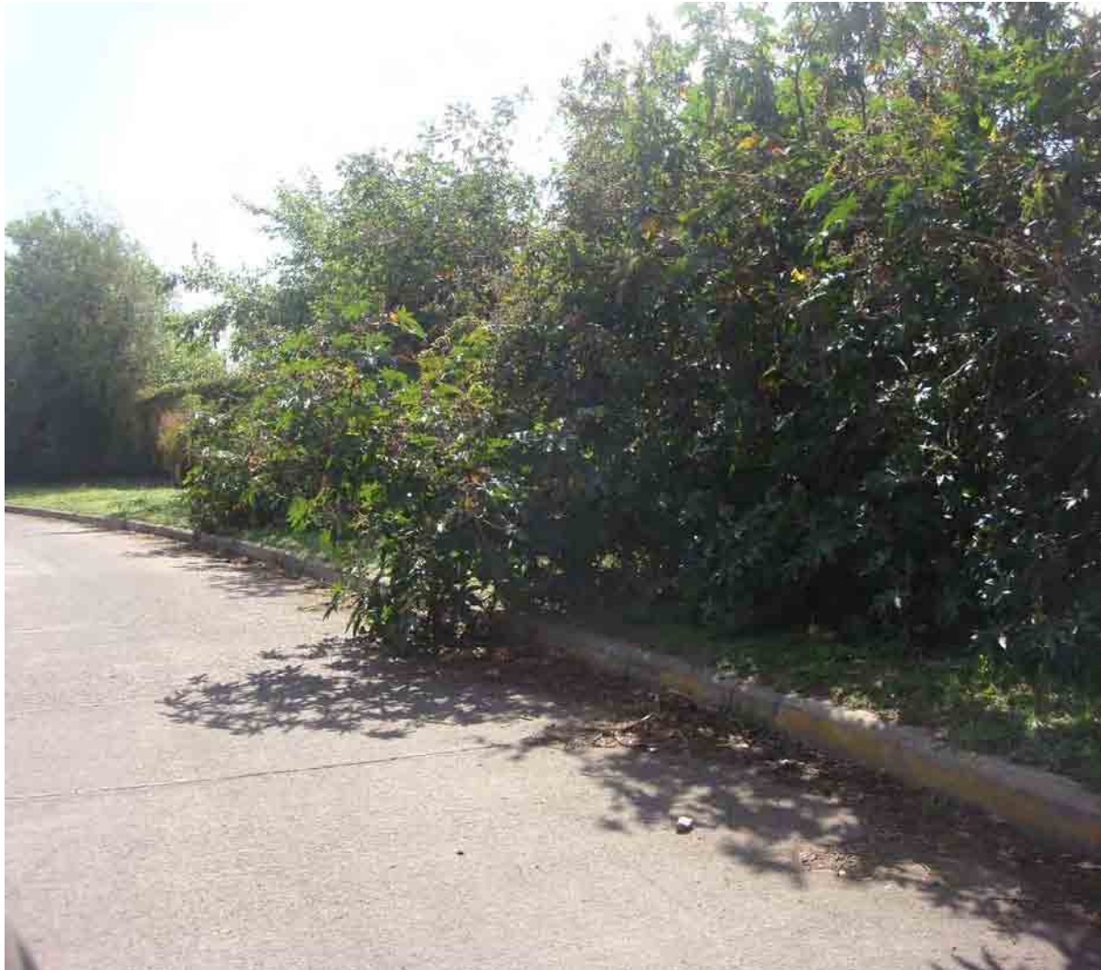
Foto N ° 20: Vegetación ocupando parte de la pista, cordones sin pintar.
