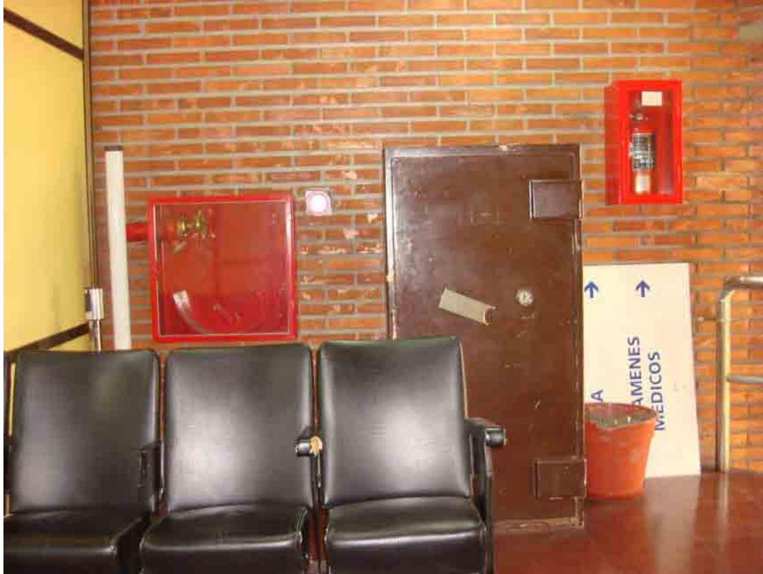
Foto N ° 4: Vista en el entrepiso donde se pueden observar sobre la pared un matafuego y a la izquierda una cabina del sistema contra incendio sin los elementos correspondientes (manguera y lanza).
